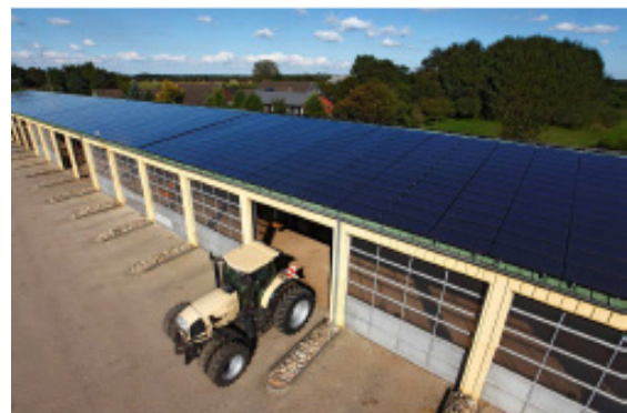
Bild: Aufdach Solaranlage mit PowerMax® Dünnschichtmodulen (Quelle: AVANCIS GmbH & Co. KG)
